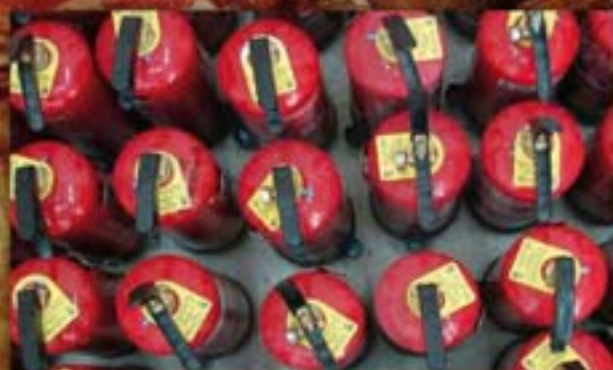
PROTECCIÓN CONTRA INCENDIOS
